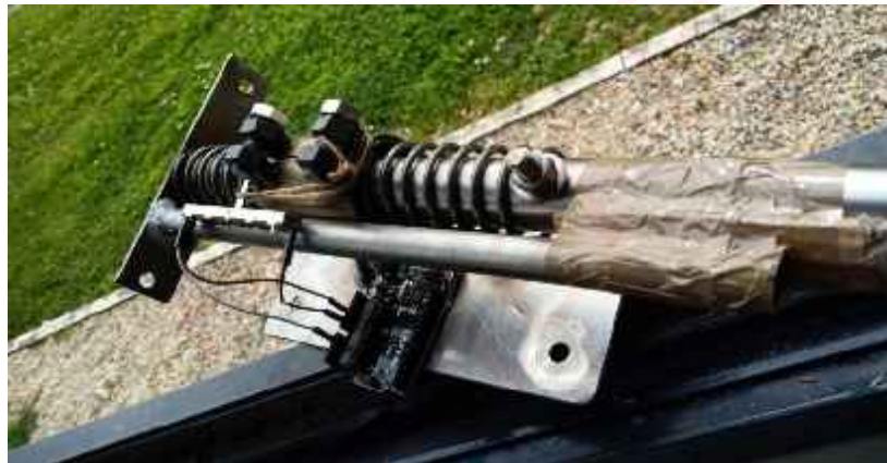
Figure 28 – Vue de loin de l'assemblage des ressorts avec le potentiomètre
